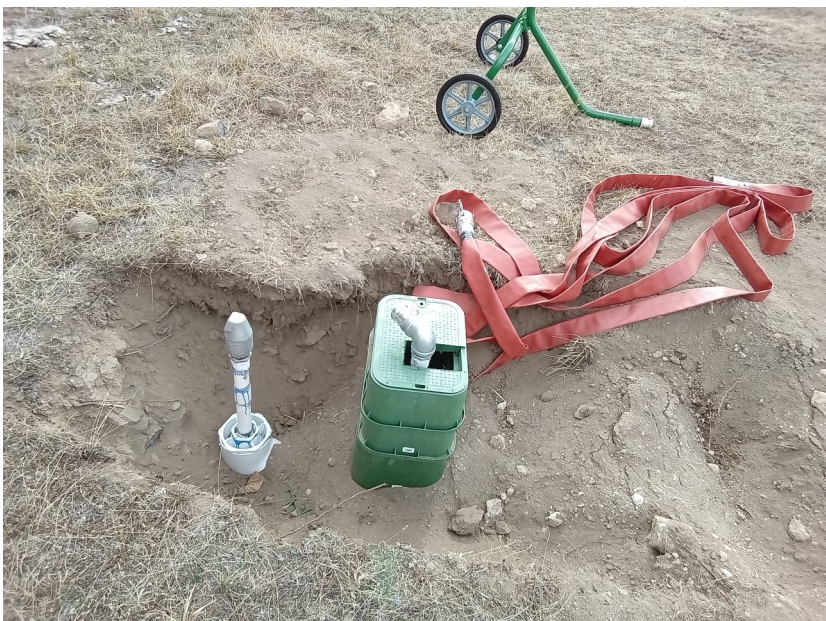
End of line with AV valve, lay flat hose for mini gun
